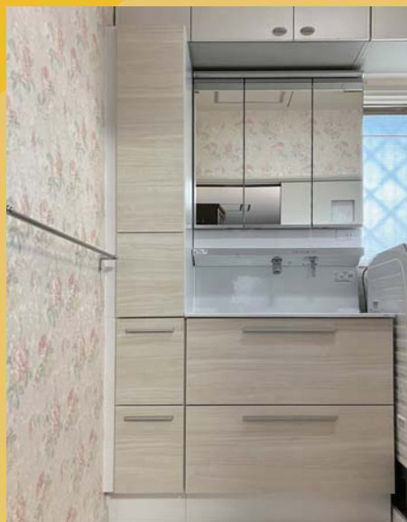
洗面台の間口を小さくして 収納スペースを増やしました
